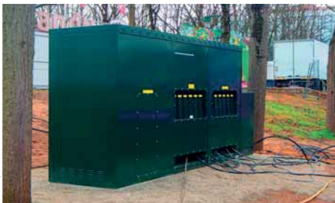
Armoire de raccordement pour festivités temporaires place du centre-ville du Mans (dpt. 72)
