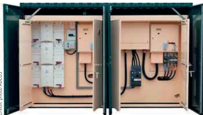
Vue côté raccordement gestionnaire du réseau de distribution
